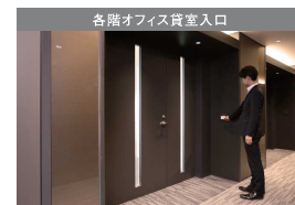
オフィス貸室入口にカードリーダーを設置し、施錠管理を実施します。
